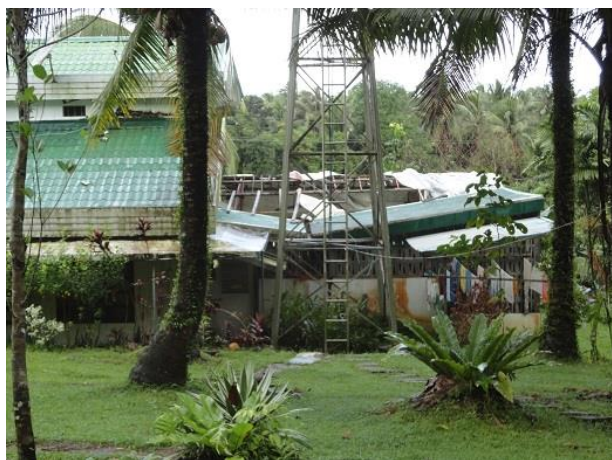
SHIFT の屋根の壊れたスタッフ・ハウス
